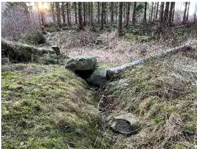
Tilstopning af grøft vest for Nordmandsvej
